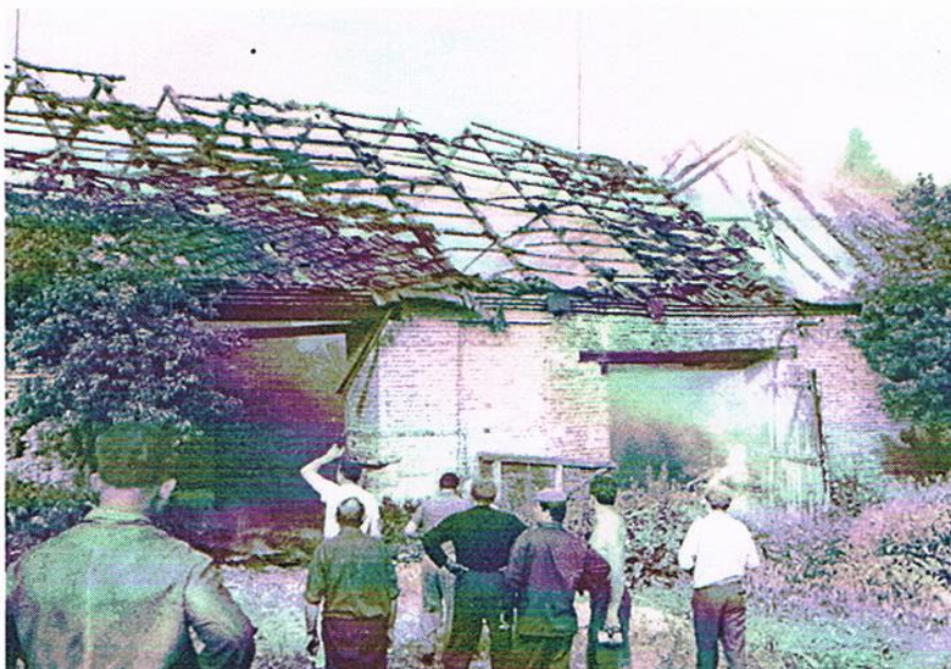
Dům č.p. 7, po požáru. Foto z roku 1968
